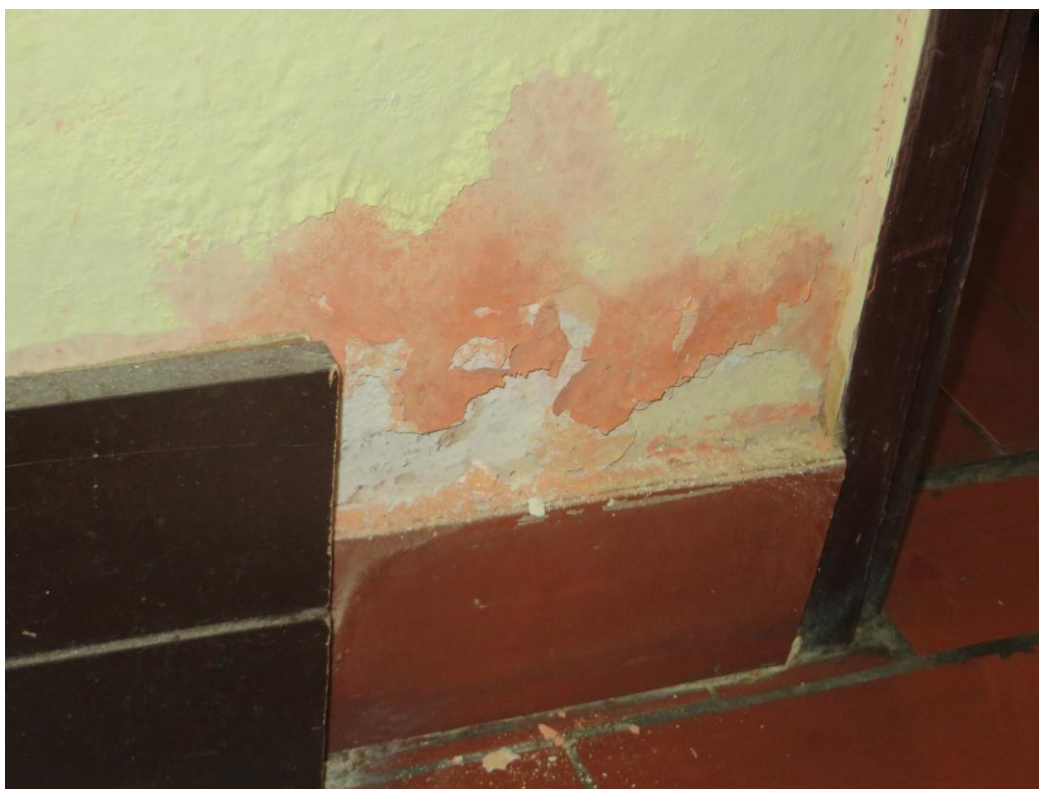
ZID SANITARNOG ČVORA PREMA HODNIKU
